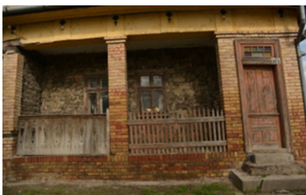
3. fotó: Felújításra várva (Forrás: Élményfalu gyűjtése)
